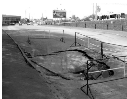
Рис. 3. Проявление суффозионных процессов (эстакада на ул. Подгорной со стороны путепровода по ул. Хатаевича г. Гомеля) (фотография автора)
